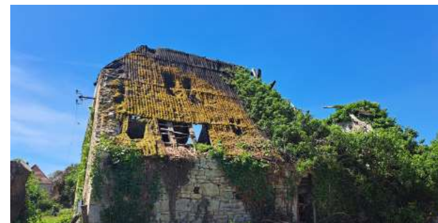
Habitation ancienne en péril d'effondrement
