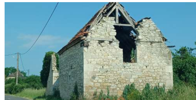
Bâti en pierre dégradé
