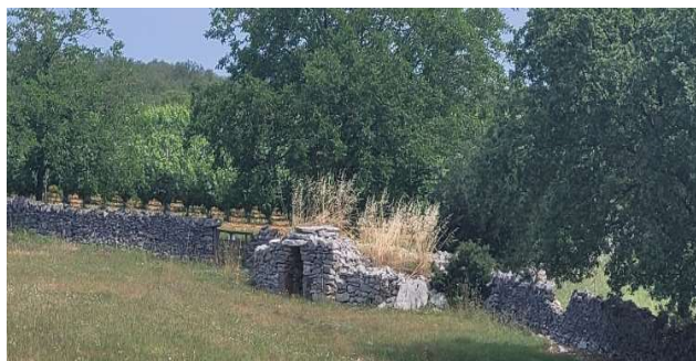
Gariotte partiellement démolie présente au Nord
